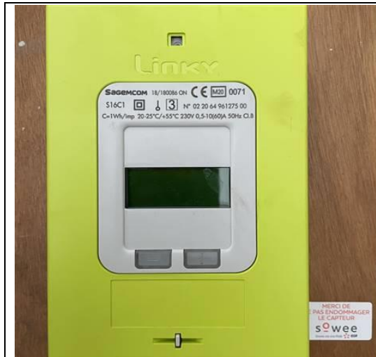
Photo du Compteur électrique
