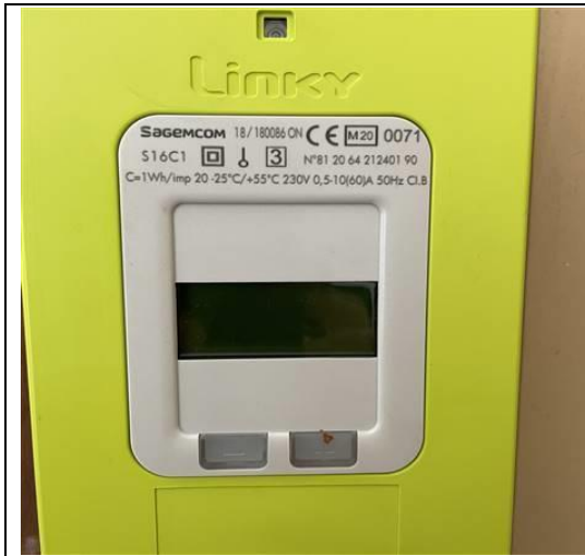
Photo du Compteur électrique
